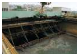
Decantador Retangular. Dispositivo de Remoção de Lodo Mecanizado.
