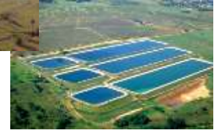
Lagoas de Estabilização - ETE Lins.
