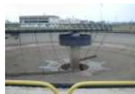
Decantador Circular. Dispositivo de Remoção de Lodo Mecanizado.
