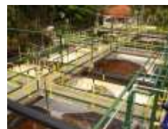
Tanque de Aeração
